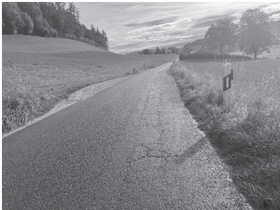
Rissiger und ausgemagerter Belag
